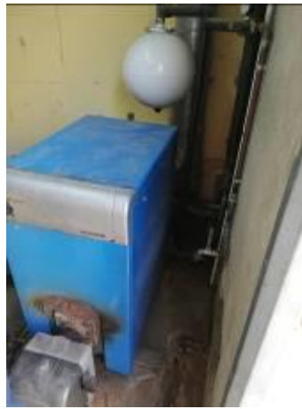
Figura 2. Caldera de gasoil
