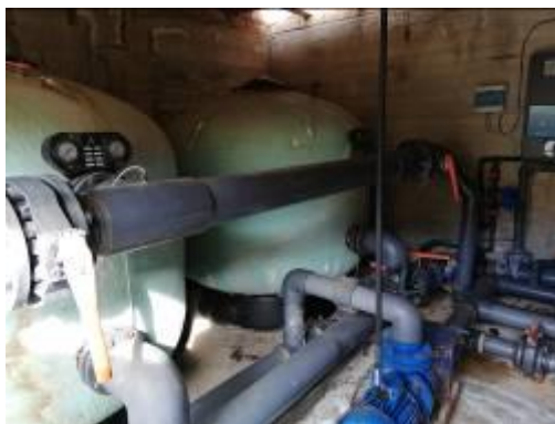
Figura 3. Sistema de depuració de la piscina
